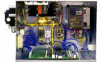
Photo:インバータ制御ボックス
